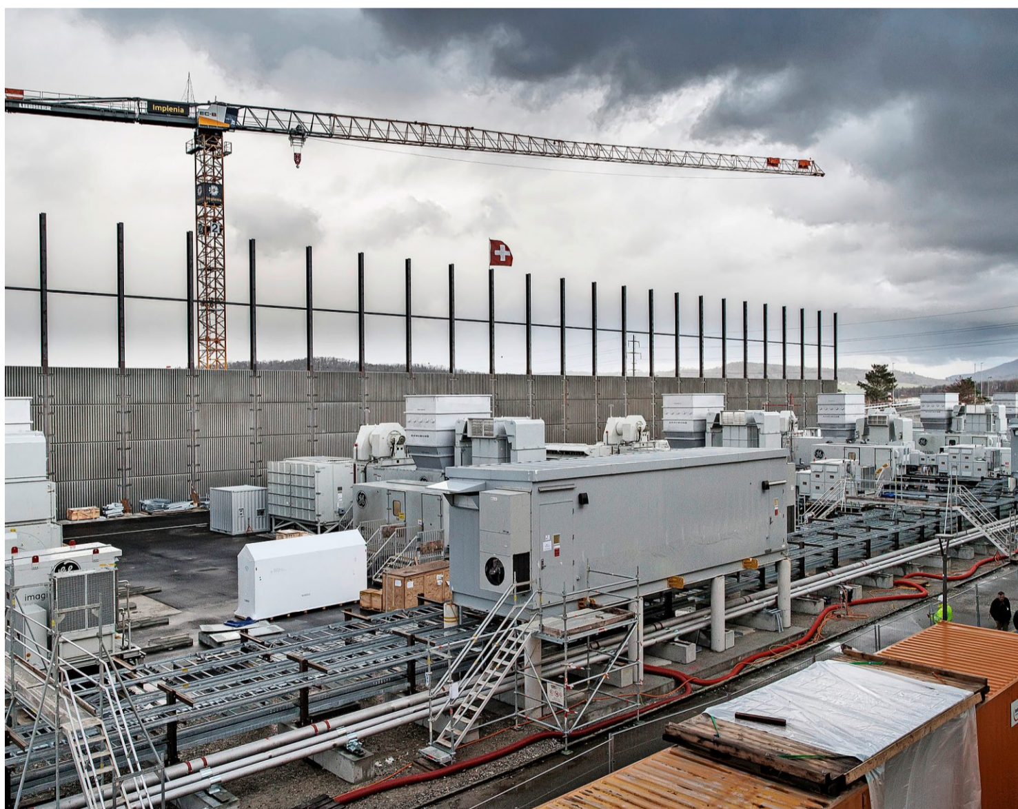
Das temporäre Reservekraftwerk in Birr wurde inzwischen ausser Betrieb genommen. Foto: Dominique Meienberg
